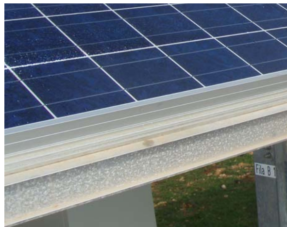
Bild 4 Ablagerungen an regengeschützten Oberflächen
