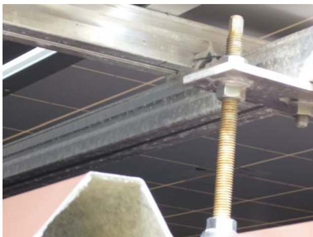
Bild 3 Korrosionserscheinungen in Küstennähe
